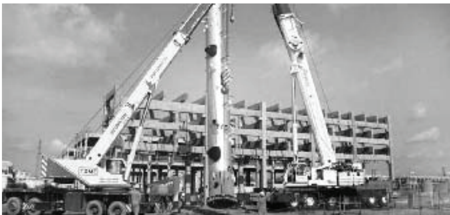
Le Comperj de Rio de Janeiro, et les travailleurs de la construction civile de Belém.
